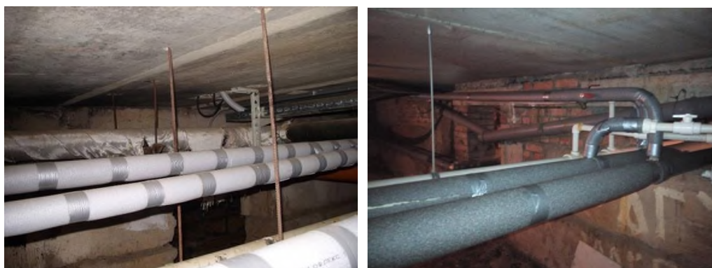
Рисунок 11. Пример теплоизоляции труб в подвальном помещении
